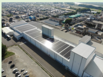
犬山工場の屋上に設置された1,608枚の太陽光パネル、発電出力は約500kW
