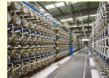
海水淡水化プラント
