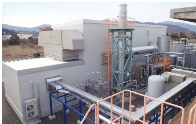
敦賀事業所 ガスコージェネレーション設備
