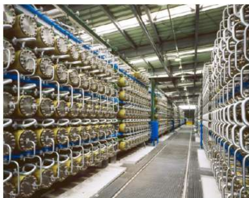
海水淡水化プラント
