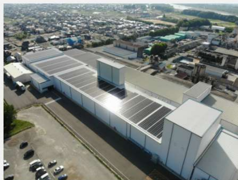
犬山工場の屋上に設置された1,608枚の太陽光パネル 発電出力は495kW
