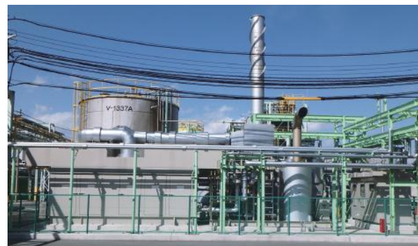
ガスエンジン(1,000kW)、排熱回収ボイラー エネルギー年間削減量(原油換算)533kℓ CO 2 年間削減量 1,137トン
