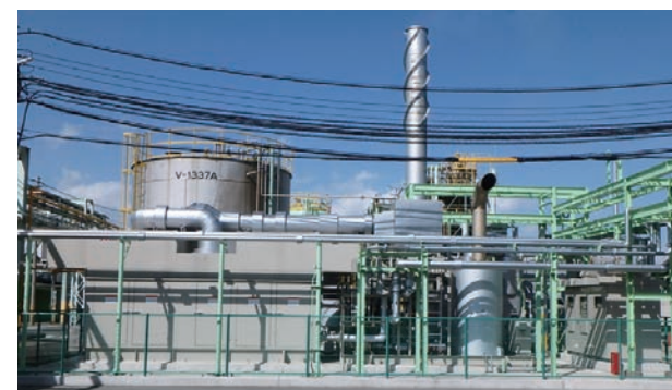
ガスエンジン(1,000kW)、排熱回収ボイラー エネルギー年間削減量(原油換算)259kℓ CO 2 年間削減量 1,335トン
