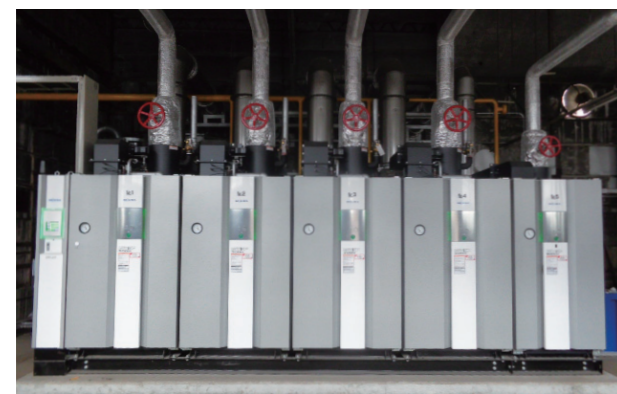
ガスボイラー(三重工場)
