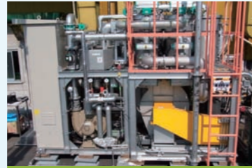
溶剤回収プラント
