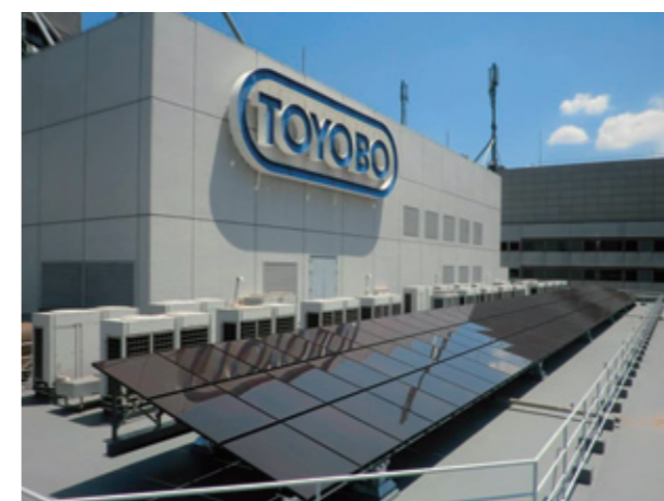
太陽光パネルを設置した本社ビル(大阪)
