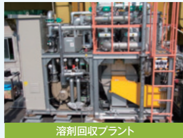
溶剤回収プラント
